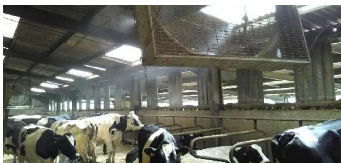
► Utilisation de brumisateurs en bâtiment
